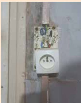
Installation électrique de la famille C.
